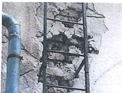
hibajelenség a homlokzaton
